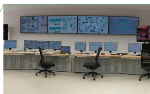
水処理監視制御システム
