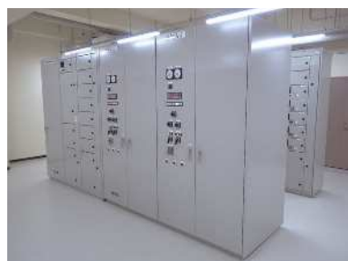
3 ポンプ場動力制御装置 Pump station power controller 泵站电源控制装置
