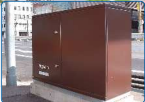
地中配電用地上設置形開閉器塔 Ground switchgear tower for underground distribution systems 地下配电网地面设置型开关柜
