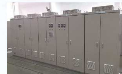
インバータ・PLC 制御装置
