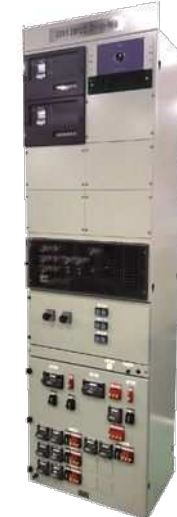
7 バンク・フィーダー保護盤 Bank feeder protection board 馈线保护盘
