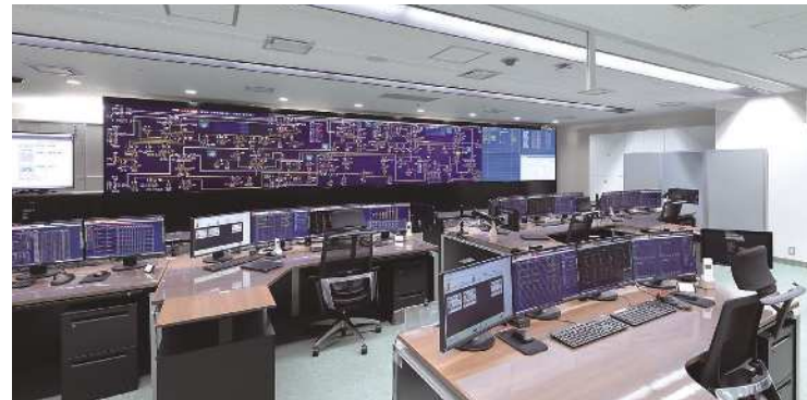
2 系統給電制御システム Grid power supply control system 调度供电控制系统
