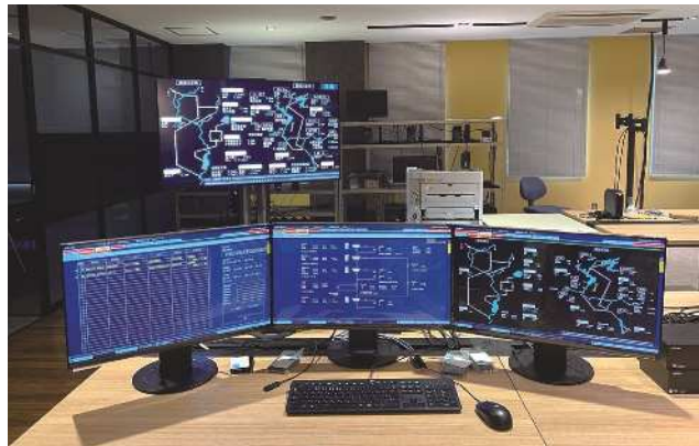
1 水力発電所監視制御システム Hydroelectric power plant monitoring and control system 水电站监视控制系统
