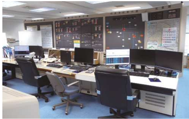
3 広域型配電線自動制御システム Wide-area distribution line automatic control system 广域配电网自动控制系统
