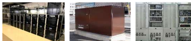
変電・配電装置 地中化用開閉器塔 電気所サーバ（通信装置）
