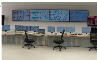
水処理監視制御システム
