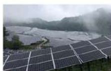
太陽光発電システム
