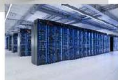
データセンター
