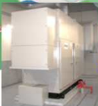
非常用発電設備
