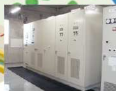
照明制御受変電システム
