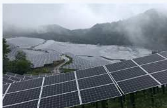
太陽光発電システム
