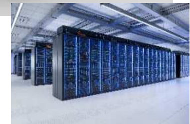
データセンター
