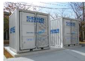
中容量 蓄電システム
