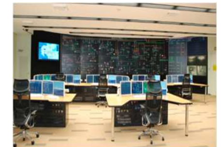
水力発電所制御システム
