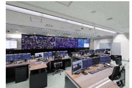
系統給電制御所システム
