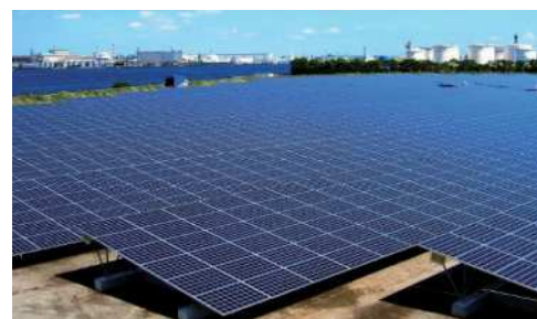
太陽光発電関連設備
