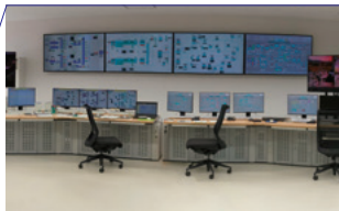
水処理監視制御システム
