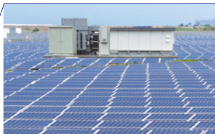
太陽光発電設備
