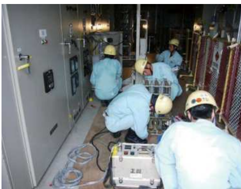
変電所配電盤試験
