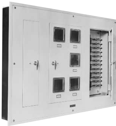
1959年 電通仕様分電盤
