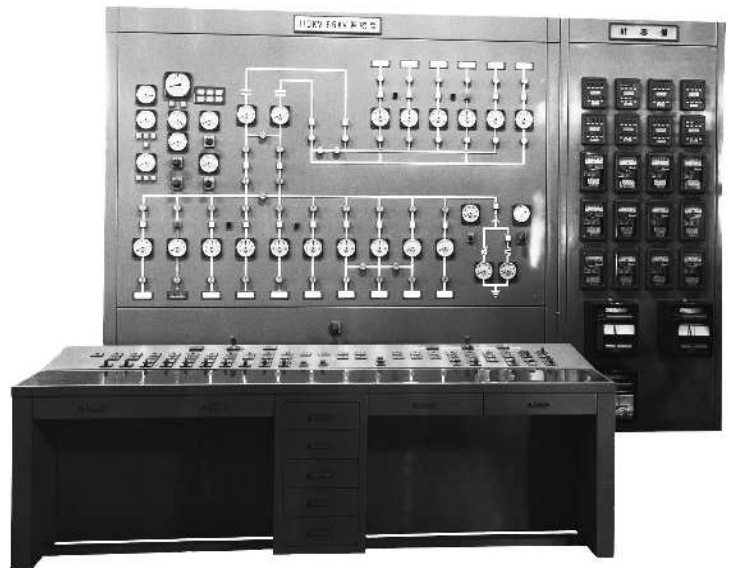
1959年 九州電力(株)武雄変電所超高压監視制御盤
