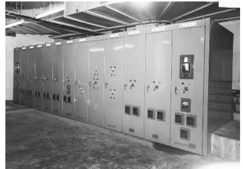
1958年 岩田屋デパートユニットサブステーション
