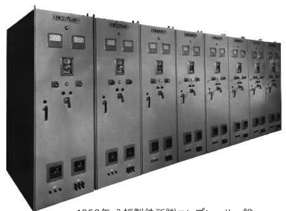
1958年 八幡製鉄所(株)コンプレッサー盤
