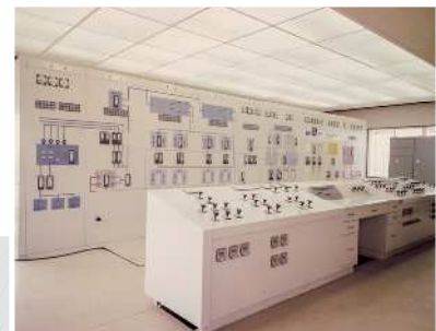
1974年 古賀町浄水場監視制御盤納入
