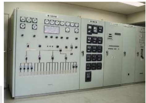
1979年 福岡市こども病院 データロガー付電力監視制御盤納入
