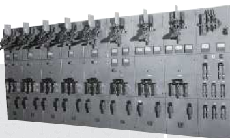
1956年当時の高圧配電盤
