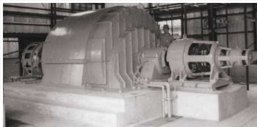
1966年に設置された短絡遮断試験設備(250MVA)の竣工
