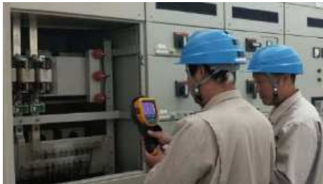
電気設備メンテナンス
