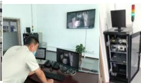
24時間設備監視サービス
