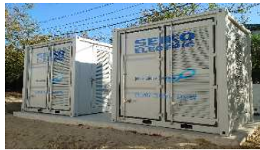
出力100kVA 電池容量215kWh
