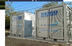
蓄電システム
