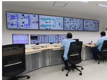
浄水場監視制御システム
