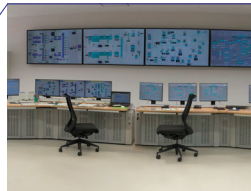
水処理監視制御システム
