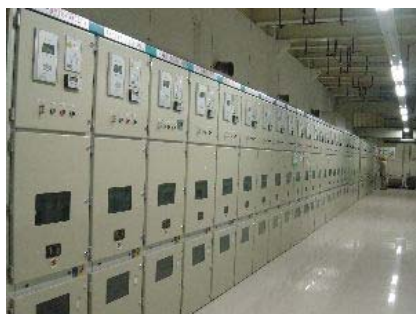
■ 10kV 中圧配電盤
