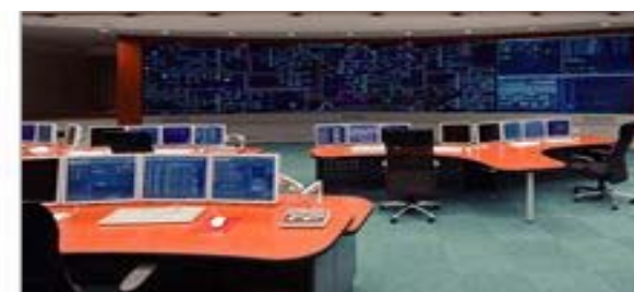
配電自動化システム
