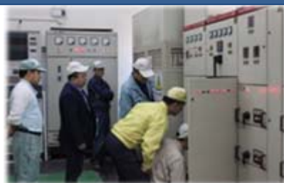
電気設備メンテナンス
