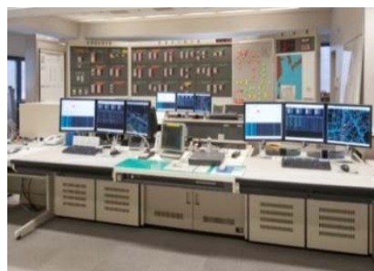
広域型新配電自動化システム
