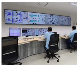
浄水場監視 制御システム
