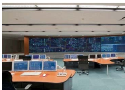
新総合制御所システム
