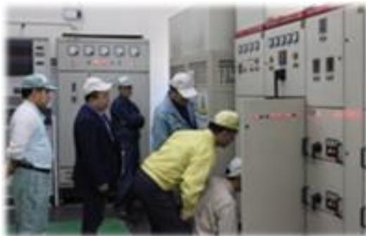
電気設備メンテナンス
