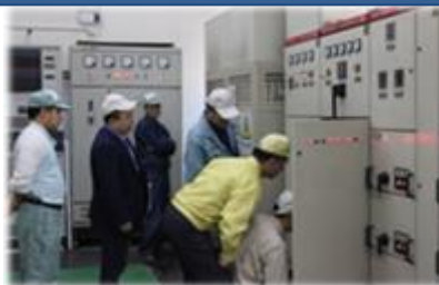
電気設備メンテナンス
