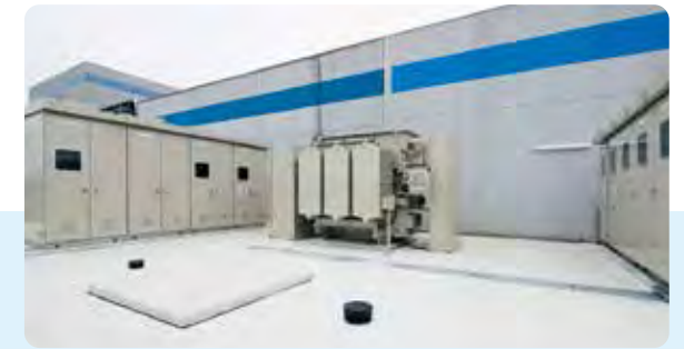
■20~6kV受変電設備 (屋外) Metal-enclosed switchgear for 20~6kV (Outdoor) 20-6kV 受变电设备 (屋外型)
