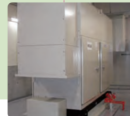
■トンネル照明用非常用発電設備・受変電設備 Emergency power system and Metal-enclosed switchgear for road lightings 隧道照明用紧急发电设备、受变电设备
