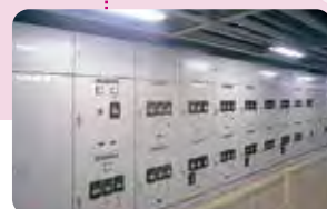
■メタルクラッドスイッチギヤ (6kVモーター制御用) Metal-enclosed switchgear (for 6kV motor) 金属铠装开关柜 (6kV 马达控制用)
