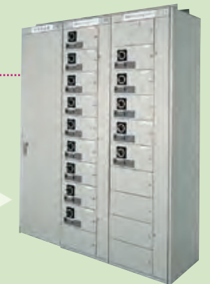
■下水処理監視 制御システム Sewage Disposal Monitoring Control System 污水处理厂监视控制系统
