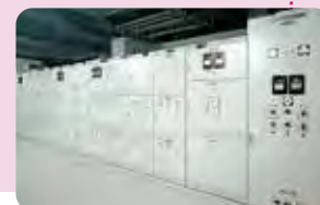
■460Vパワーセンタ Power center (for 460V) 460V 动力中心
