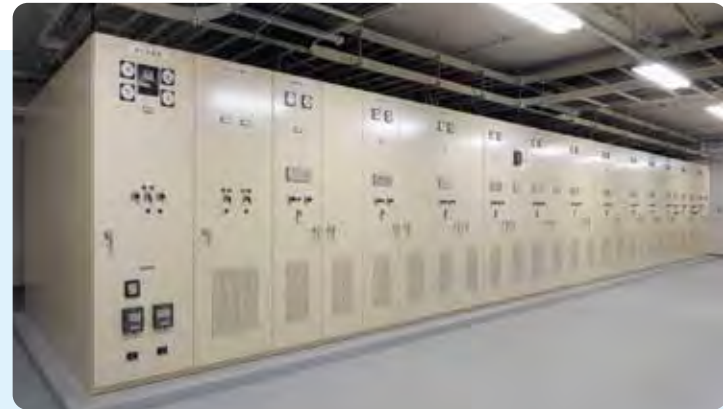
■高・低圧配電設備 High and low voltage switchgear 高、低圧配电设备
