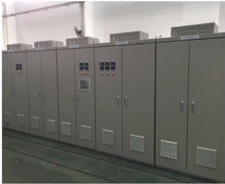
インバータ・PLC制御装置
