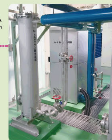
■バイオガス発電システム Biogas power generation system 沼气发电系统
