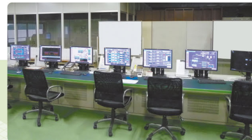
■下水処理監視制御システム Sewage Disposal Monitoring Control System 污水处理厂监视控制系统
