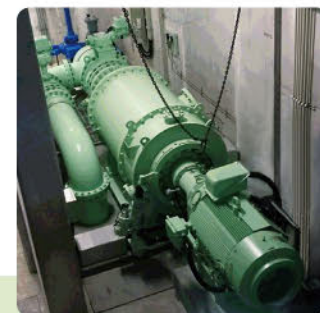
■小水力発電システム Small hydro power generation system 小型水力发电系统
