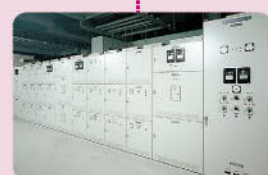
■460Vパワーセンタ Power center (for 460V) 460V 動力中心
