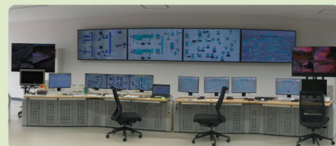
■浄水場監視制御システム Monitoring Control System for Water Purifying Plant 自来水厂监视控制系统
