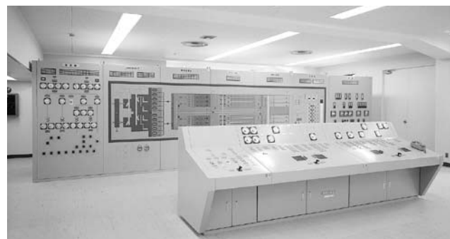
昭和53年古賀町役場下水処理場監視制御盤
