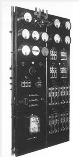
昭和30年頃の発電機制御盤
