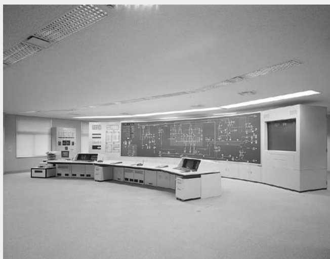
500kV変電所集中制御所
