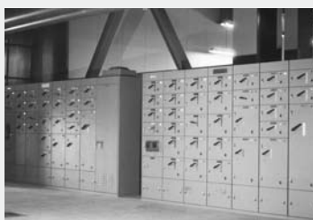
新小倉発電所納 MCC
