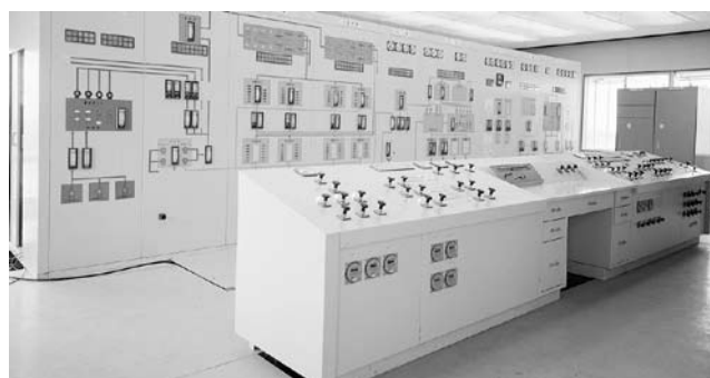
昭和49年古賀町役場浄水場監視制御盤
