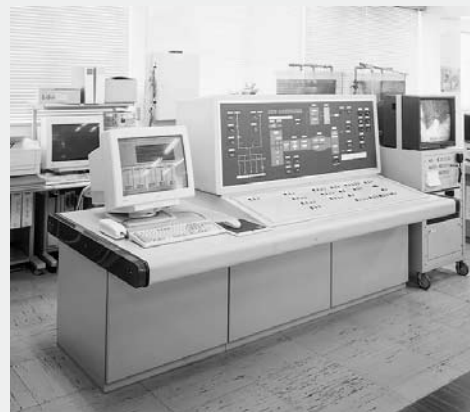
平成4年福岡市高宮浄水場監視制御盤
