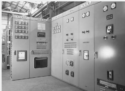
昭和46年北九州バイパス猪倉トンネル納 照明・換気制御盤
