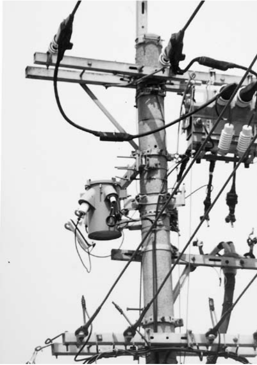
制御電源専用変圧器
