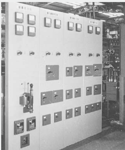
西日本新聞社受電設備
