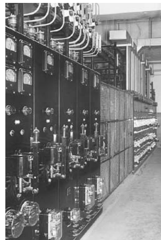
昭和27年電気ビル納 鋼板盤 第1号高低圧盤
