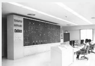
500 kV中央変電所
