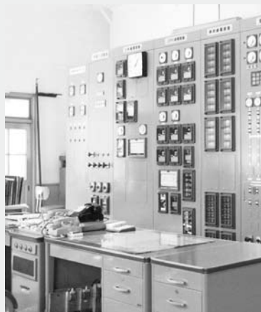
配電用変電所遠方監視制御盤
