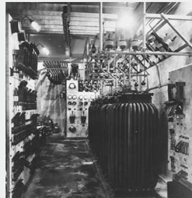
昭和11年岩田屋納 受電設備
