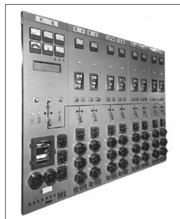
昭和32年頃の自家発電用監視制御盤
