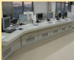
水処理監視制御システム
