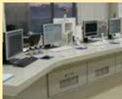
水処理監視制御システム
