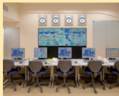
水処理監視制御システム
