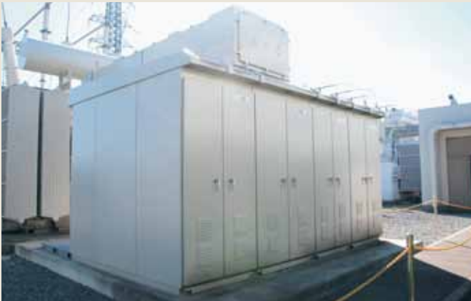
22kV簡易配電箱(屋外)
