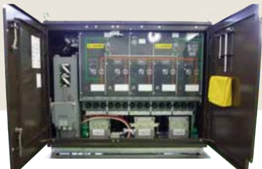
③開閉器塔(多回路用)
